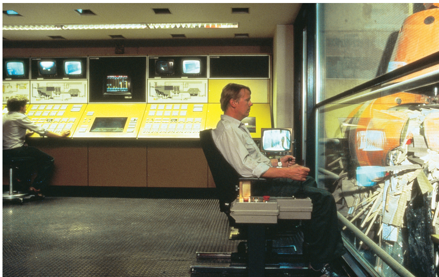
Sala di controllo di un impianto di termovalorizzazione. Al di là di quanto affermato in recenti polemiche, un termovalorizzatore è un impianto complesso e dalla tecnologia sofisticata, che non può essere in alcun modo paragonato ad un classico inceneritore, pur se provvisto di dispositivi per l'abbattimento dei fumi
