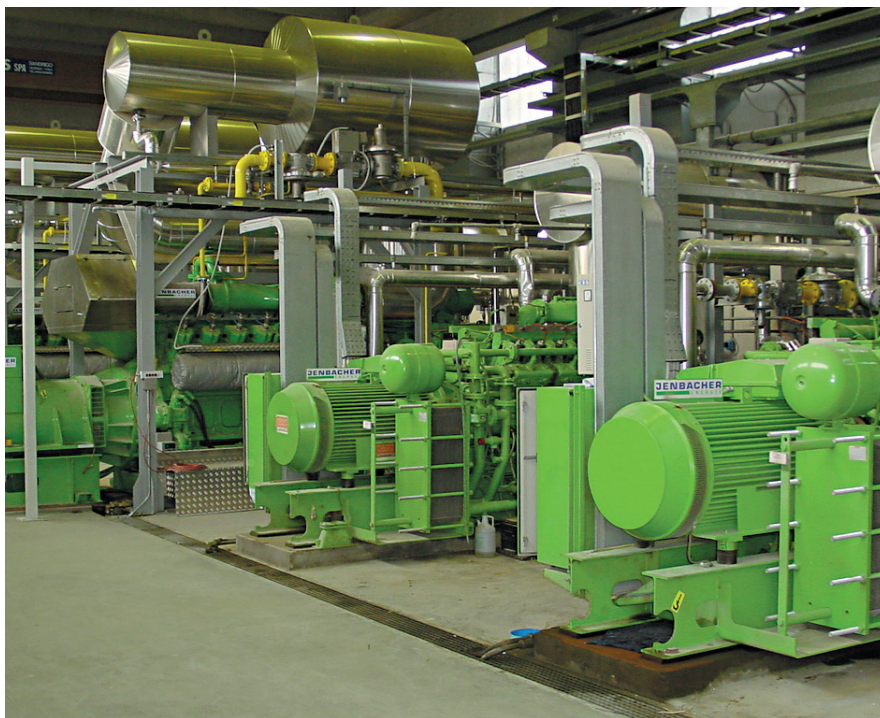
Impianto di produzione di energia elettrica con recupero di biogas: sala motori
