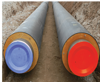
Tubazioni di trasporto del teleriscaldamento
