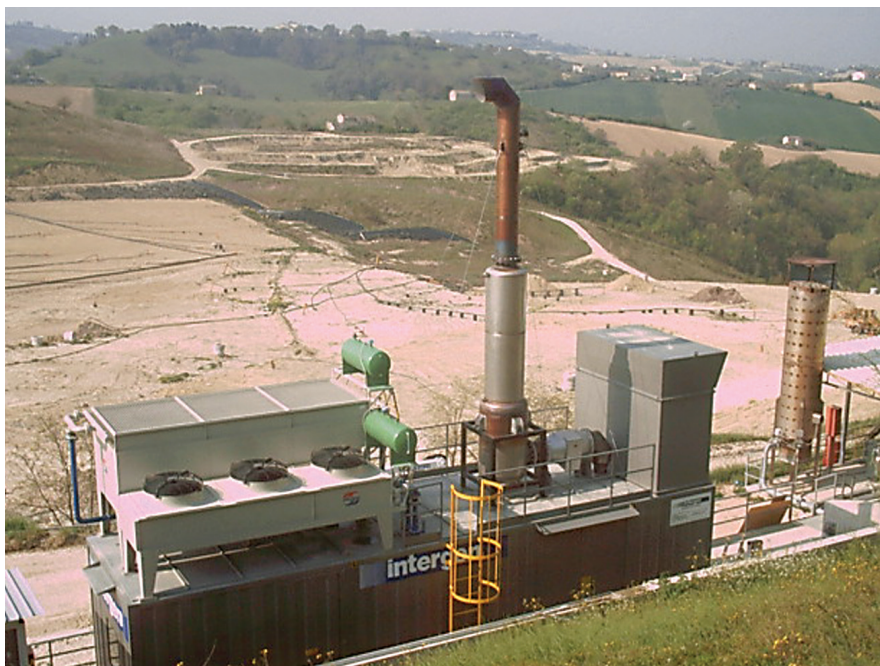
Impianto di valorizzazione energetica del biogas presso la discarica di rifiuti solidi urbani di Fermo (AP)
