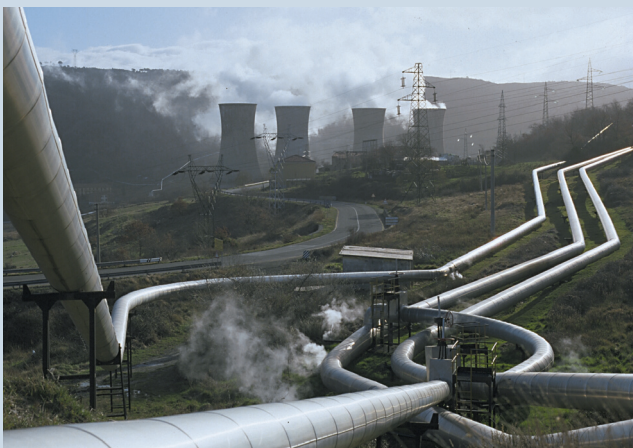
Impianto geotermico Enel di Larderello (Pisa)
