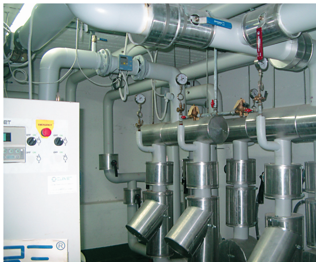
Impianto oceanotermico CLIMARE; un particolare della sala macchine
