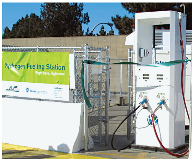
Stazione di rifornimento di idrogeno. [cortesia Michelin]
