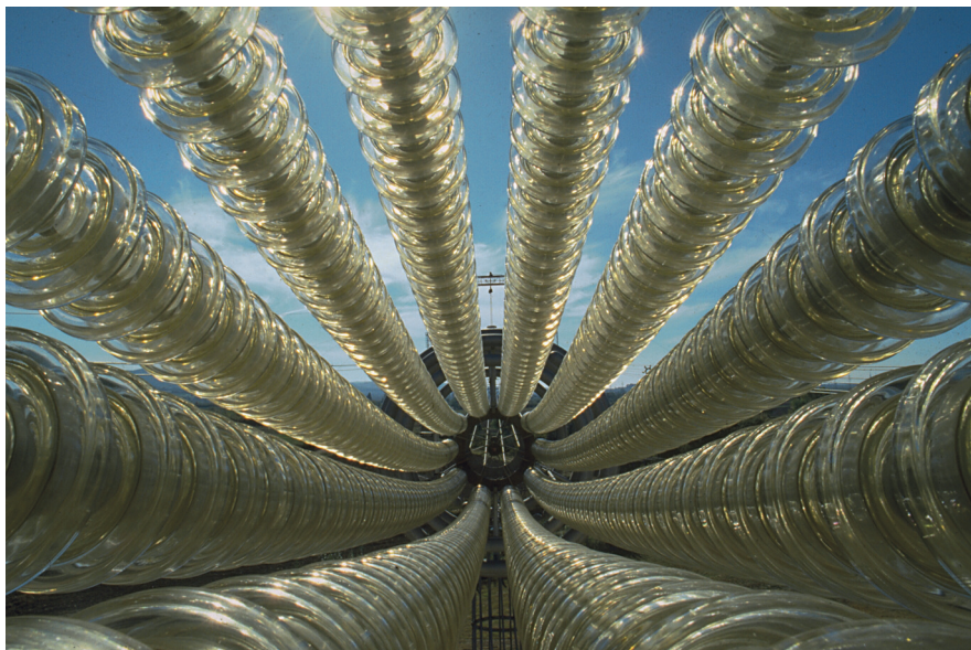
Impianto di Suvereto. Particolare degli isolatori a catena del fascio decanato. [cortesia ENEL]
