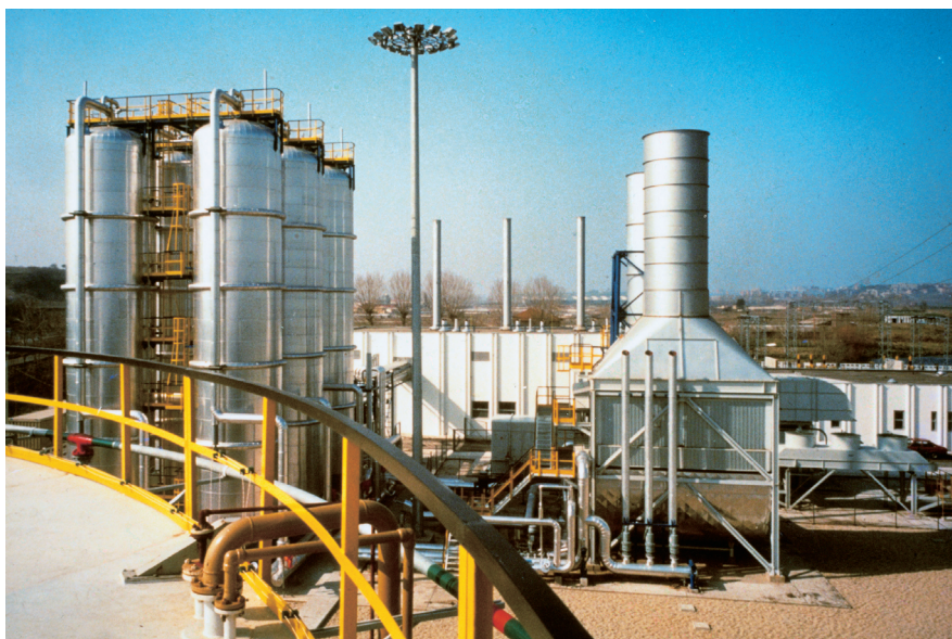
Centrale di cogenerazione di Tor di Valle. [cortesia ACEA]
