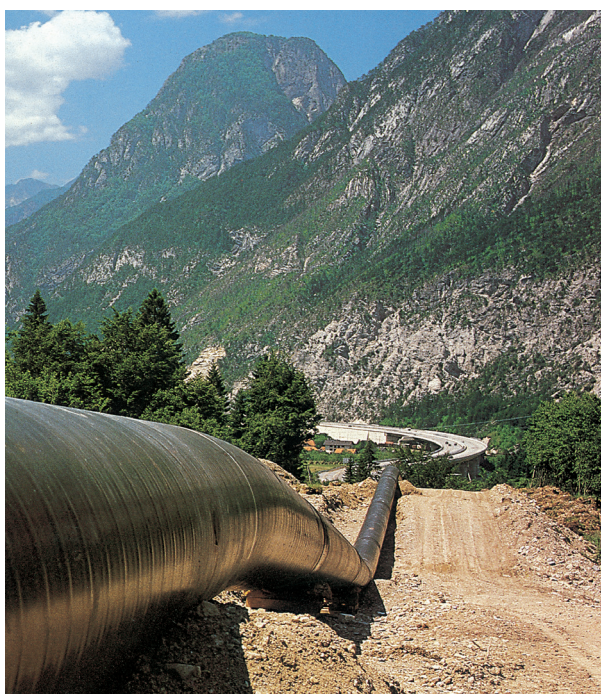
Le infrastrutture per il trasporto dell'energia e i metanodotti hanno rappresentato uno sforzo ingegneristico immenso, i cui risultati spesso non sono neppure visibili in superficie. [cortesia ENI]
