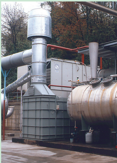
Particolare dell'impianto di abbattimento dei fumi nella lavorazione del PVC
