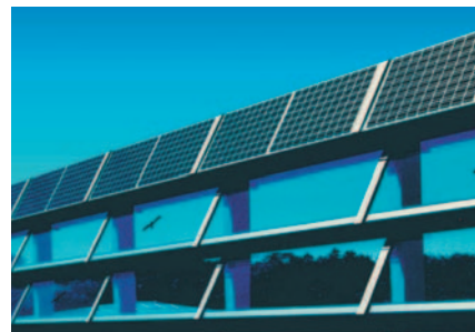
Per ottimizzare l'inclinazione sull'orizzonte dei pannelli fotovoltaici si può ricorrere a semplici strutture di sostegno a più livelli
